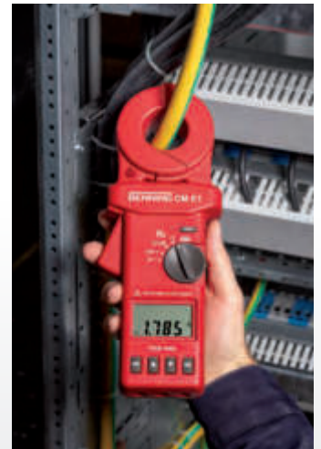
Messung des Betriebsersders einer Industrieverteilung
