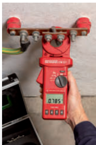
Messung des Erdschleifenwiderstandes eines Anlagenerders
