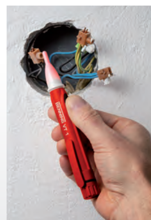
Test de phase sur les boîtes de distribution
