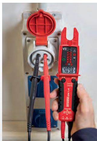
Mesures de tension et test d'ordre de phases
