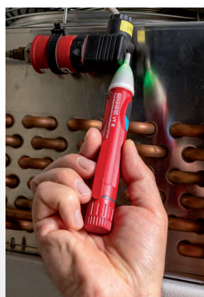
Contrôle d'une électrovanne
