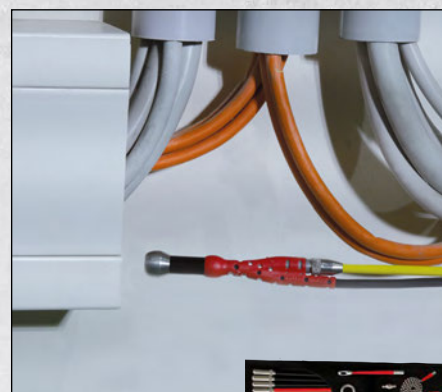
Schächte und Unterflurkanäle
