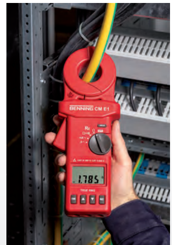
Messung des Betriebserders einer Industrieverteilung
