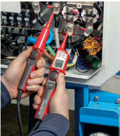
Prüfung der Ausgangsspannung einer DC-Ladeeinrichtung
