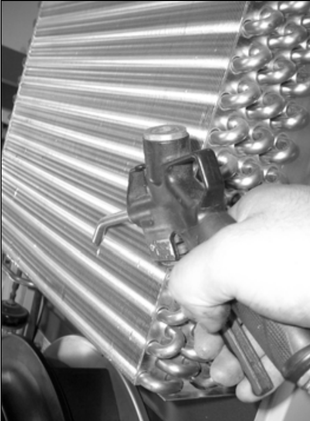
Abb. 51: Wärmetauschregister und Kompressorraum mit Druckluft ausblasen (1)
