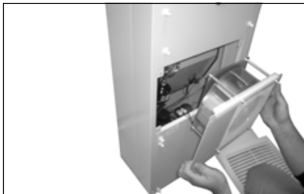
Afb. 69: Ventilator extern circuit uitbouwen
