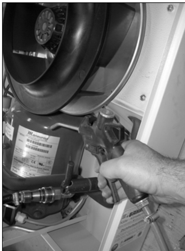
Fig. 81: Limpar os tubos do trocador de calor e o compartimento do compressor com ar comprimido (3)
