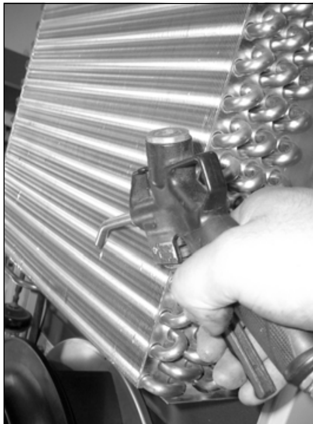
Fig. 80: Limpar os tubos do trocador de calor e o compartimento do compressor com ar comprimido (2)
