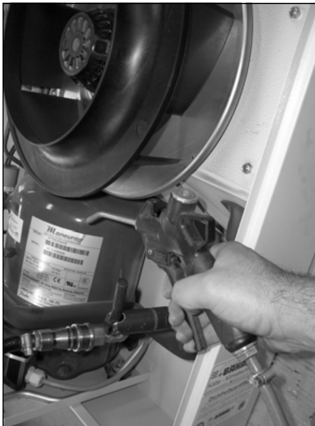
Fig. 57: Limpar os tubos do trocador de calor e o compartimento do compressor com ar comprimido (2)
