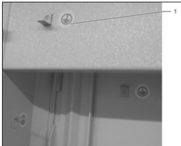
Imagen 13: Conexiones para el cable de puesta a tierra
