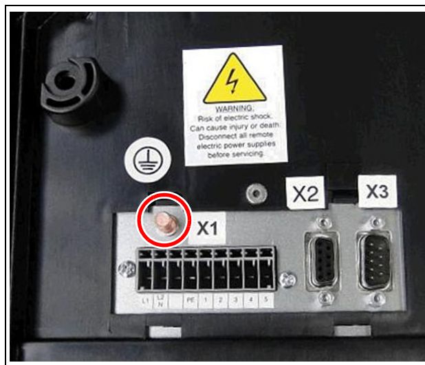
Imagen 11: Punto de conexión, compensación de potencial
