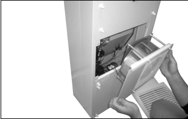
Afb. 64: Ventilator extern circuit uitbouwen
