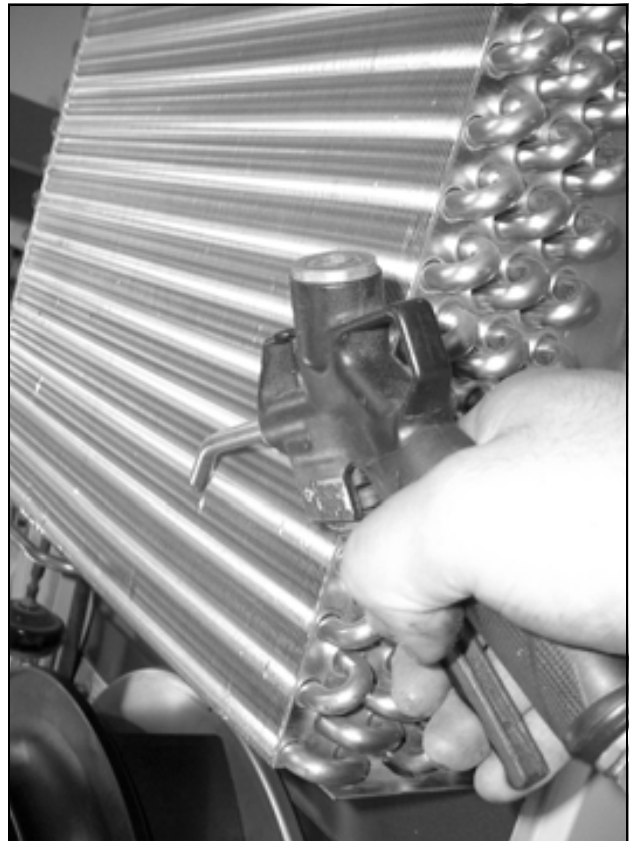
Bild 75: Rengör värmeväxelpaketet och kompressorum med tryckluft (2)
