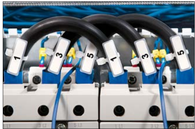
IT Kabelbinder – ein Arbeitsgang mit doppeltem Nutzen.
