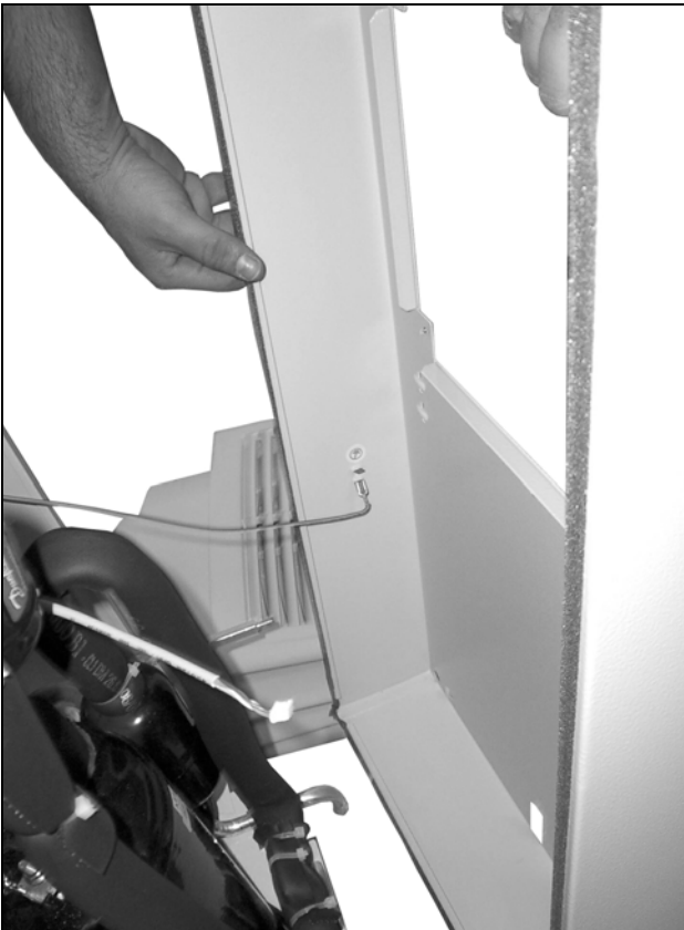
Imagen 72: Desconectar el cable de puesta a tierra (1)
