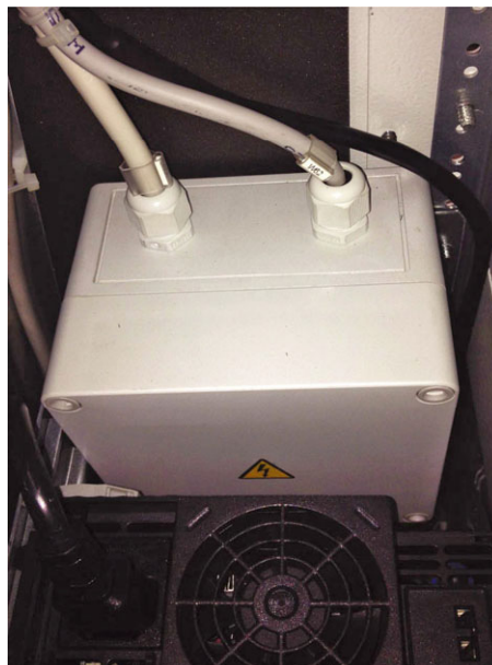
Рис. 50: Дополнительный бокс для предохранителей электрического нагревателя
