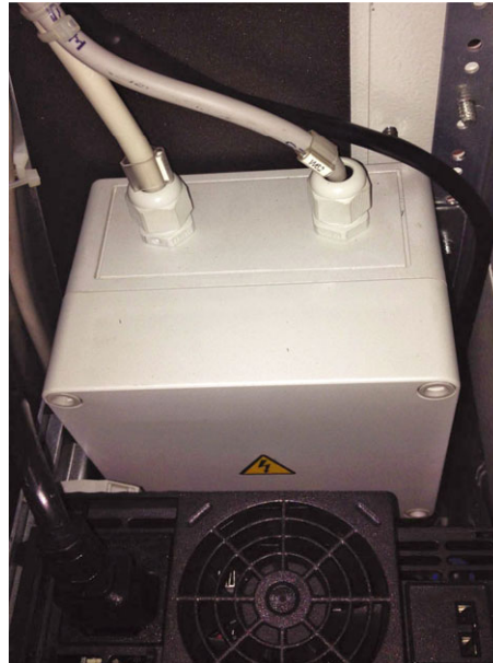
Abb. 50: Zusätzliche Box für die Thermosicherungen der elektrischen Heizer
