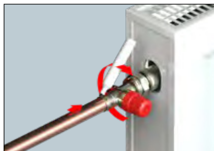
Danach wird das Rohr in die Pressmuffe des Ventils eingeführt und die Einstecktiefe mit einem Stift markiert, um sicherzustellen, dass das Rohr nach dem Pressvorgang richtig sitzt.
